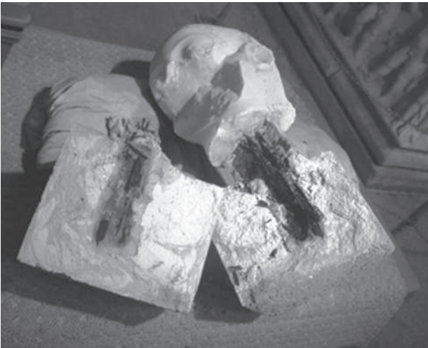
Res. 1 Demir korozyonu Fig. 1 Corrosion
